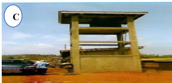
Puits aménagé du marché Tsinfem dans la ville de Dschang
