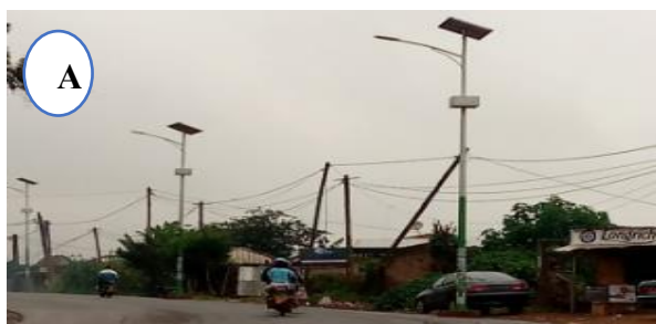
Eclairage public par énergie solaire
